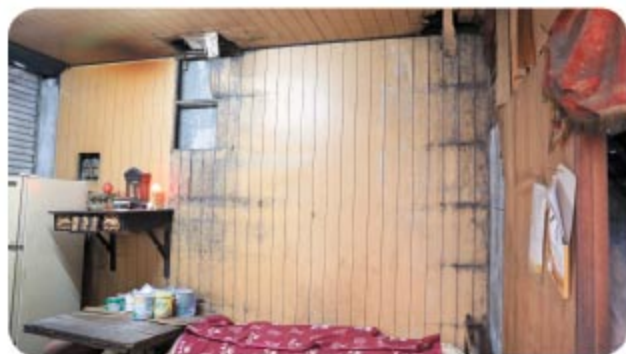
阿好阿嬤的家年久失修，漏水嚴重，霉斑處處。
